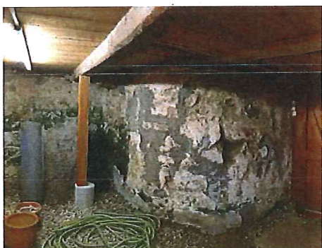
Ofenfundament im IG ursprünglich, teilweise grosse Durchbiegungen der Decken und Abstützungen.
