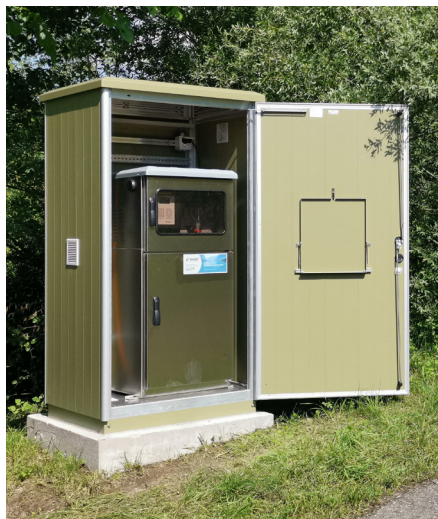
Messstation an der Glatt bei Oberbüren.
