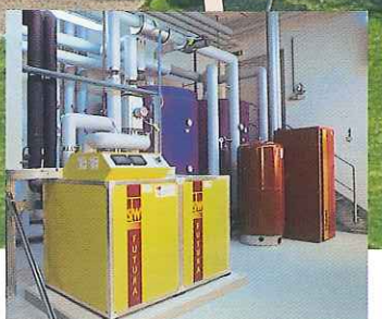
4 Wärmezentrale mit Wärmepumpe
