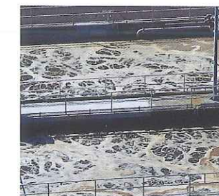
10 2. Belebungsstufe mit Lufteintrag (Biologische Abwasserreinigung)
