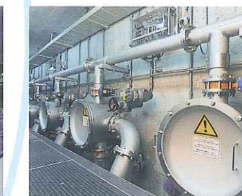
12 Filteranlage, Installationsraum im Untergeschoss
