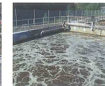
8 1. Belebungsstufe mit Lufteintrag (Biologische Abwasserreinigung)
