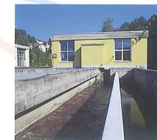
6 Öl- und Sandfanganlage
