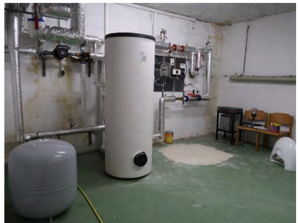
Heizung-Technik (Fernwärme) mit Boiler im UG
